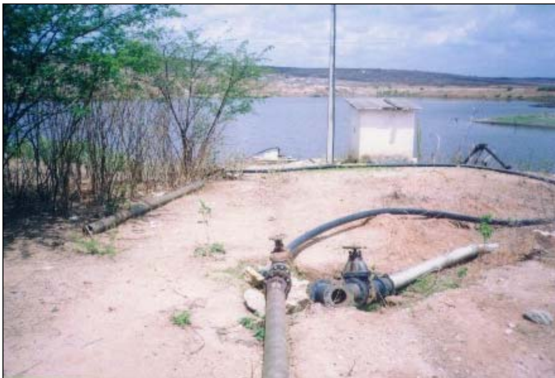
FOTO 11: E.B. Flutuante (Aç. Jatobá) / ponto de injeção da adutora do rio Banabuiu
